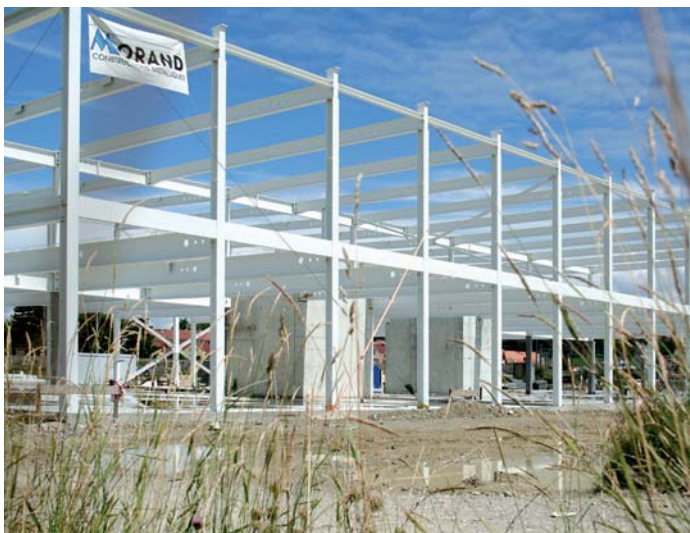
La halle Hi-Tech II, actuellement en construction au PST, accueillera notamment l'entreprise Heraeus Materials.
